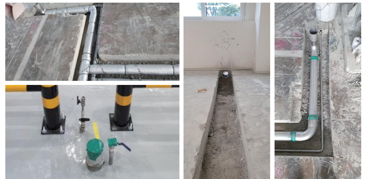
실제 설치 사진
