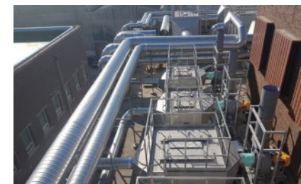
급배기 DUCT / 집진기
