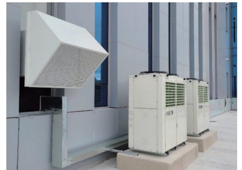
실제 설치 사진
