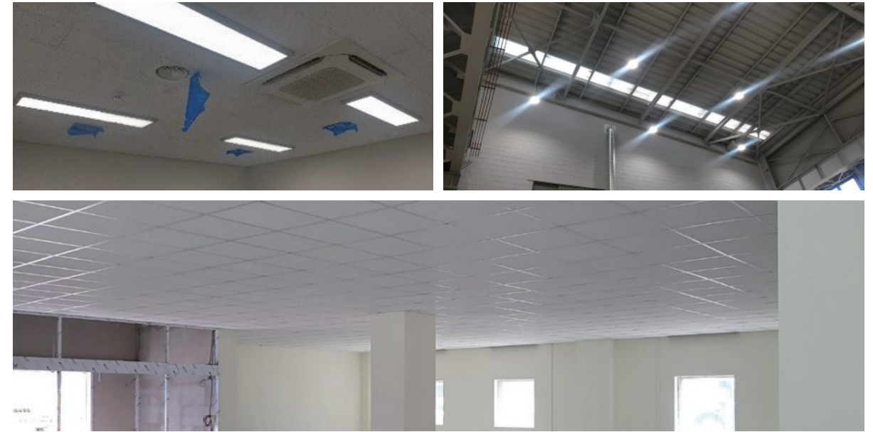
실제 설치 사진
