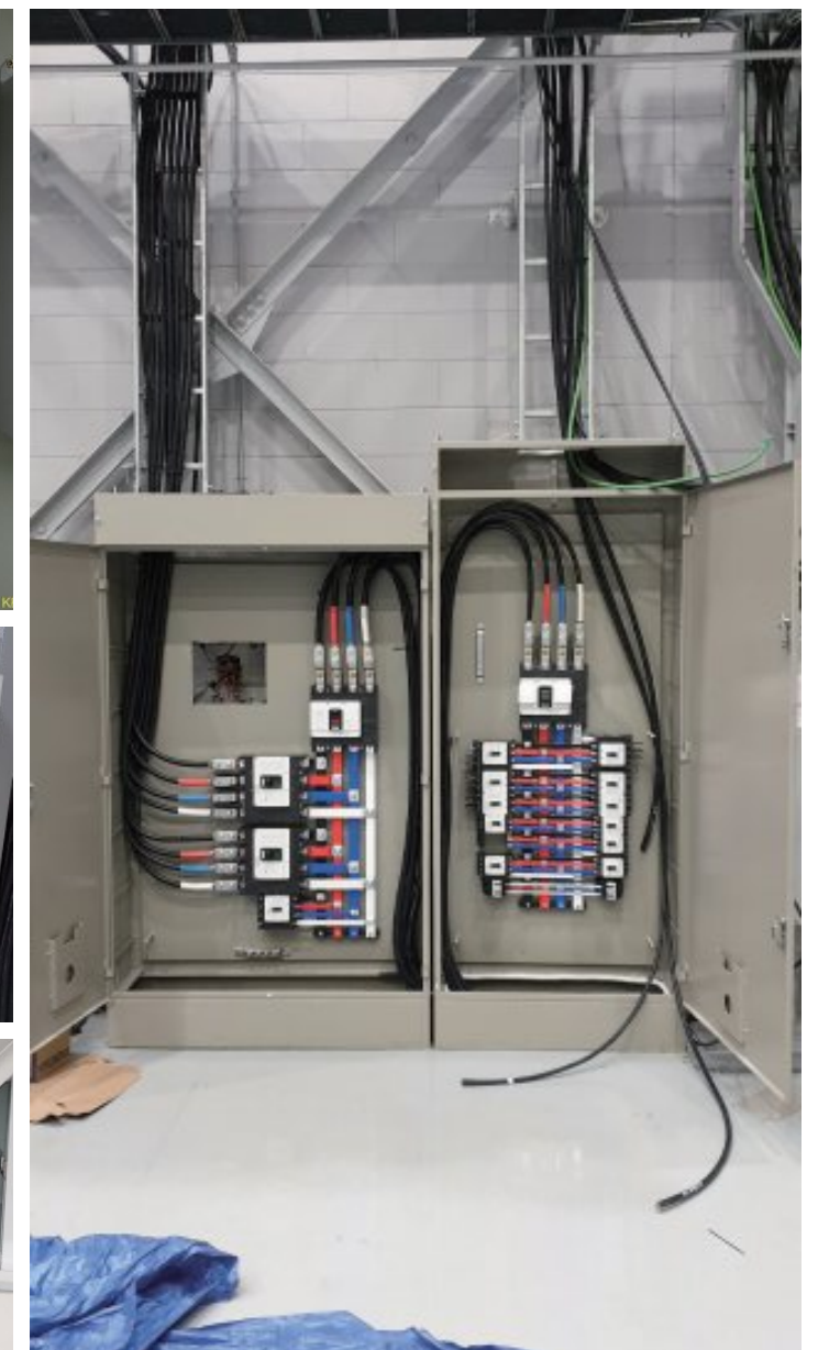
실제 설치 사진
