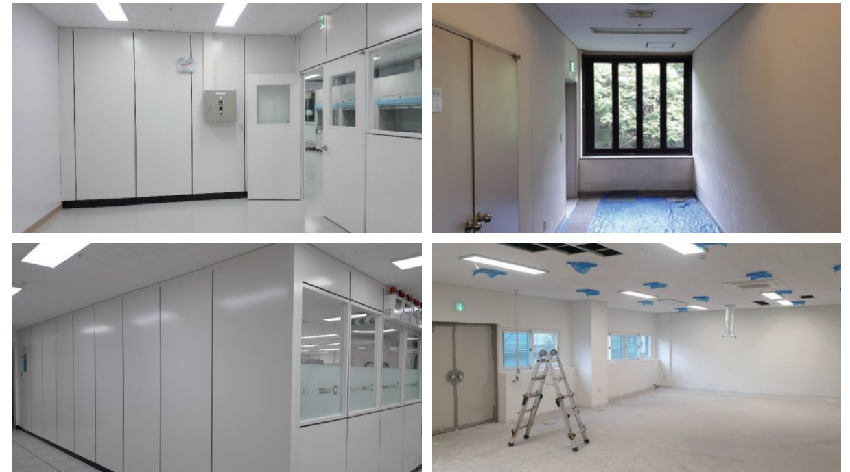
실제 설치 사진
