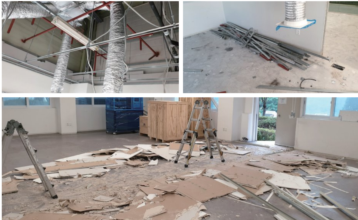
실제 설치 사진
