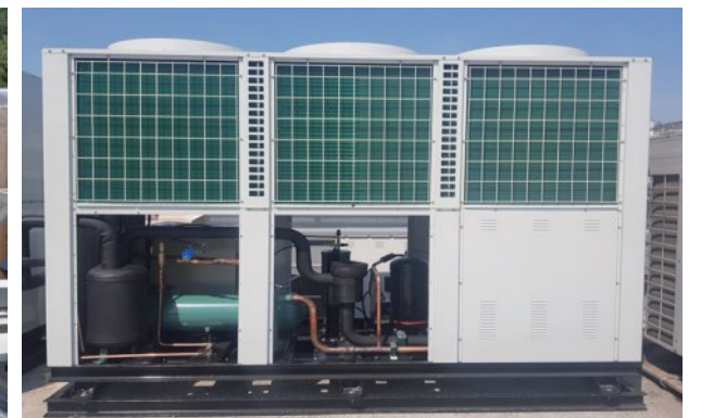
실제 설치 사진
