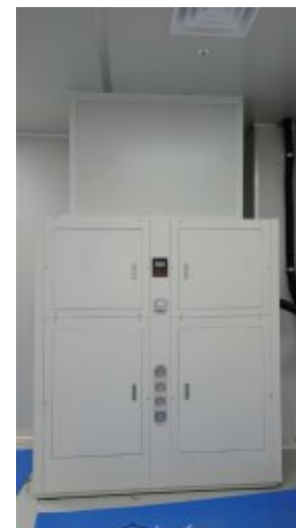
향온 향습기 설치 사진
