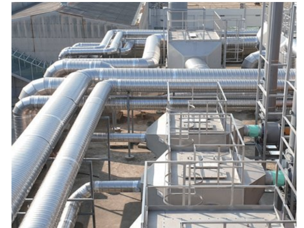
실제 설치 사진
